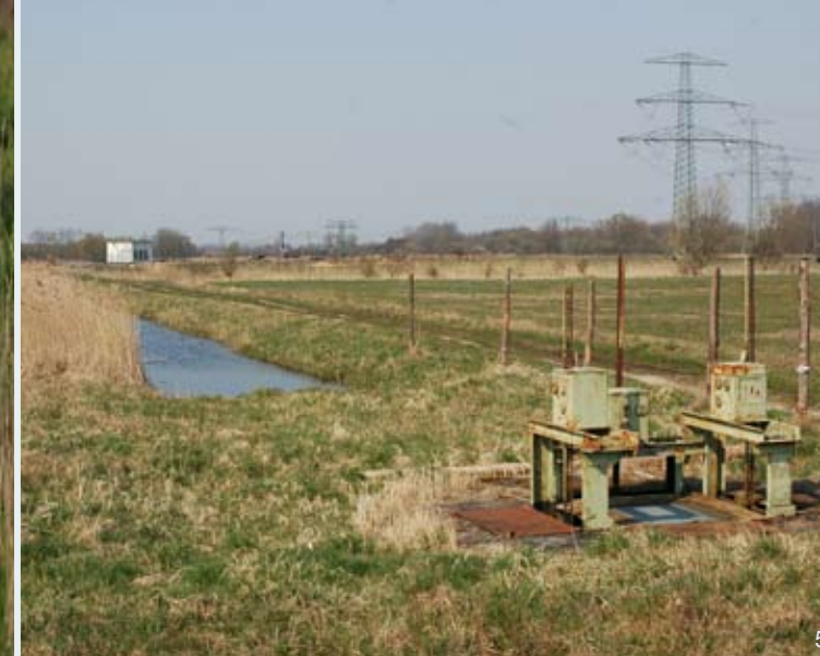
Das 1967 in Betrieb genommene Schöpfwerk entwässert ein ca. 825 ha großes Niederungsgebiet in dem Osterfor See. Mit kleineren Stauanlagen (im Vordergrund), können die Wasserstände kleinräumig reguliert werden.
